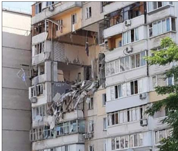
Des. 30. Urmările unei explozii de gaz
