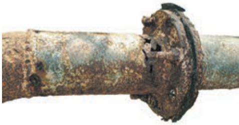
Мал. 42.4. Корозія сталеві труби внаслідок дії на метал вологи, кисню та тіонових бактерій
